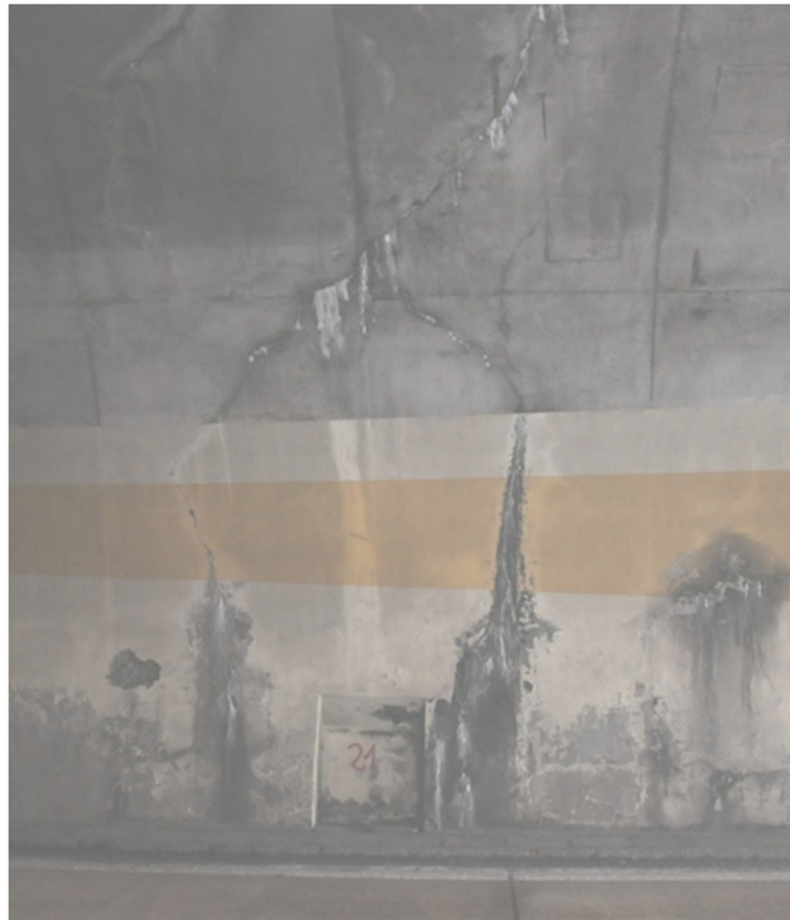
Bild 1: Ulmenfläche vor der Instandsetzung
